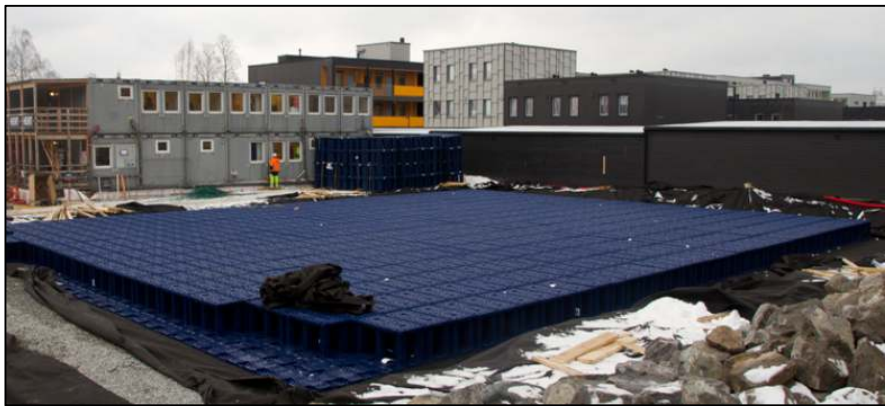
Bilde som viser basseng under en parkeringsplass
